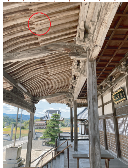
蜂の巣があった本堂外廊下の天井(赤丸印の場所)
