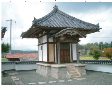
御経堂の白壁が崩落
